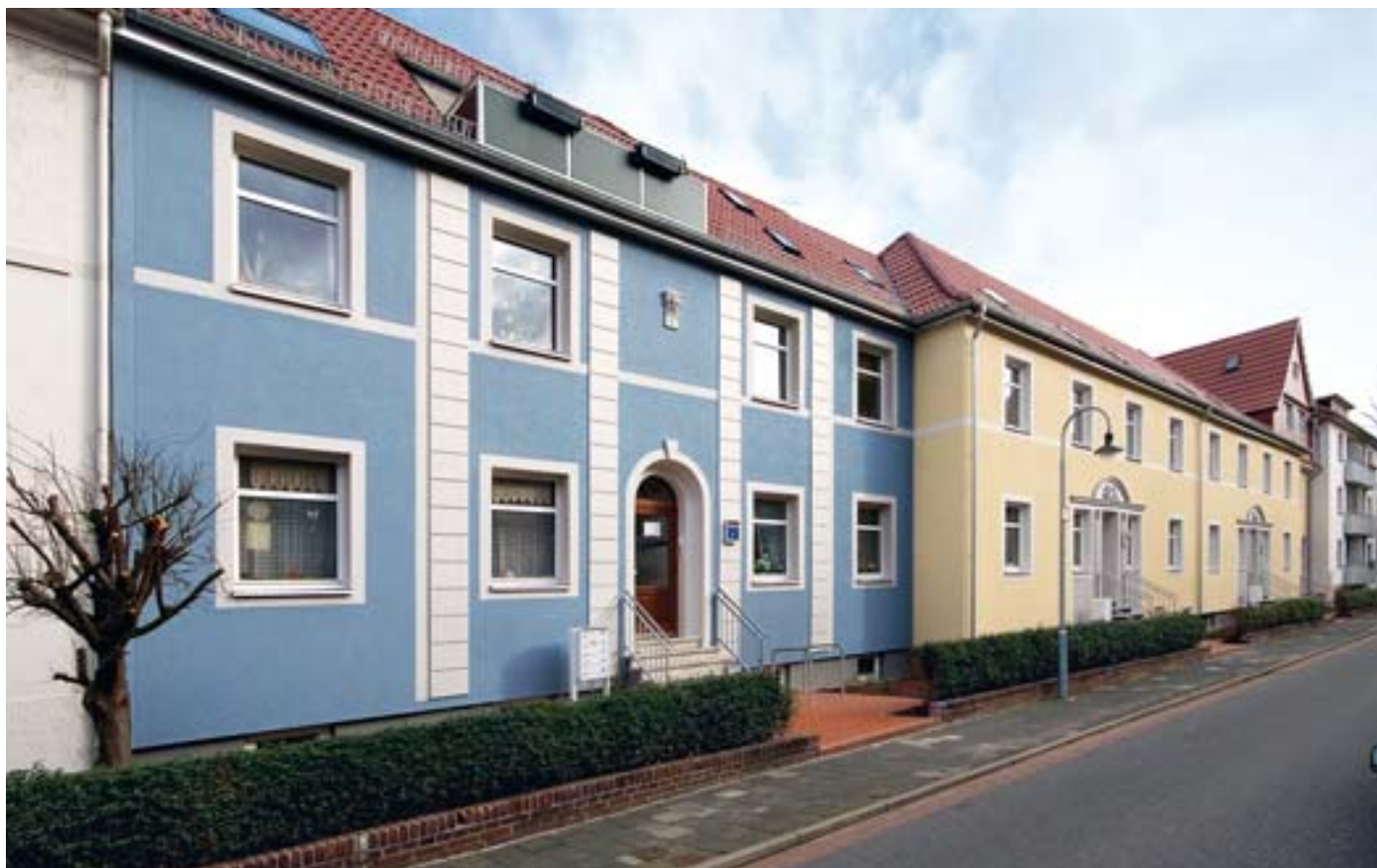
Komplett saniert und modernisiert: Nach dem Aufbringen von Wärmedämmung kamen schmückende Fassadenelemente von Capapar zum Einsatz.
